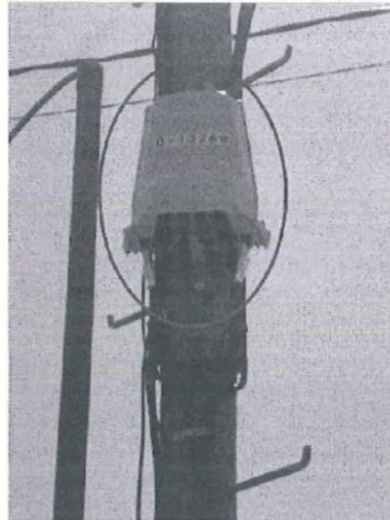
Ilustración 21. Caja terminal óptica (CTO) instalada en Poste.
