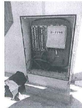
Ilustración 22. Caja terminal óptica (CTO) instalada en Pedestal.
