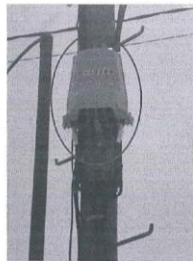
Ilustración 21. Caja terminal óptica (CTO) instalada en Poste.
