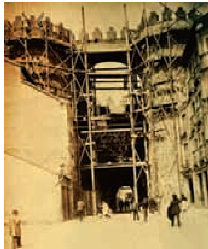
Puerta del Alcázar. Reconstrucción de Almenas. Arquitecto E.M. Repullés. Contratista A. Prieto. Foto Isidro Benito. Año 1907.
